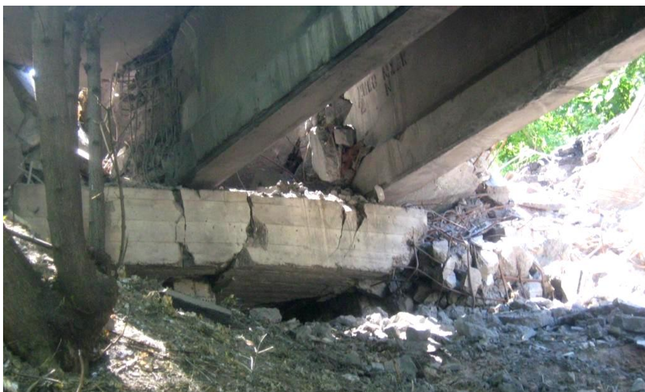
Рисунок 2.3 – Руйнування пального фундаменту на високому ростверку внаслідок підриву боеприпасом великої потужності
