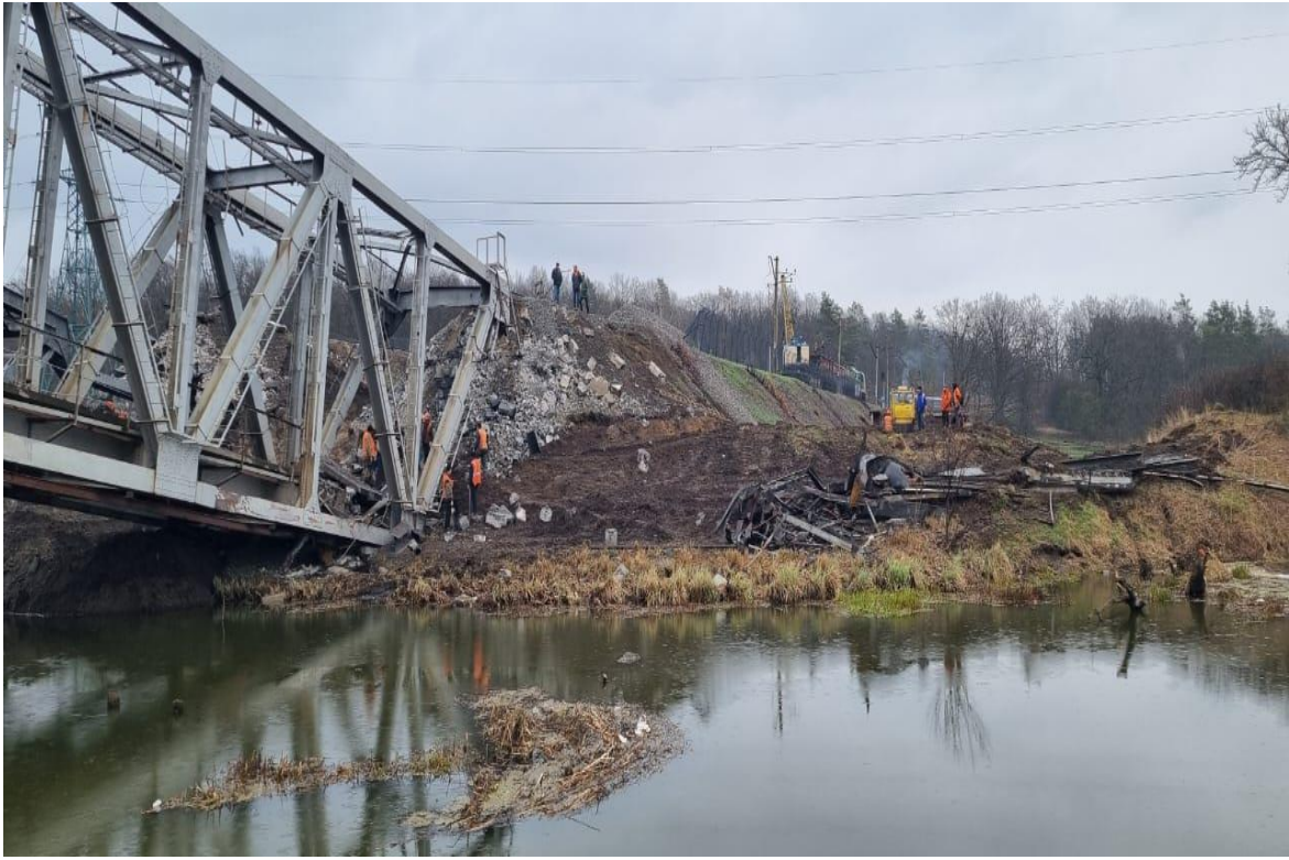
Рисунок 3.16 – Вид залізничного мосту після руйнування
