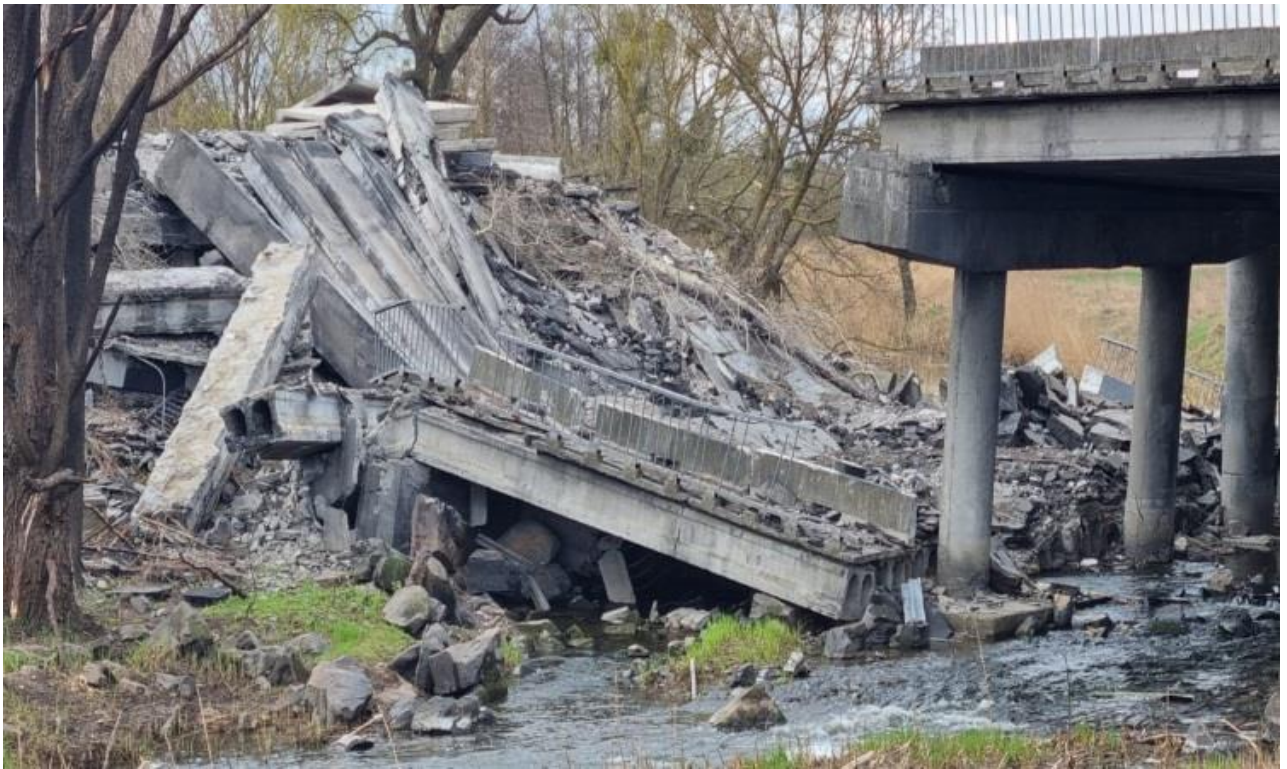
Рисунок 3.3 – Повне руйнування конструкцій опор та прогонових споруд автомобільного мосту
