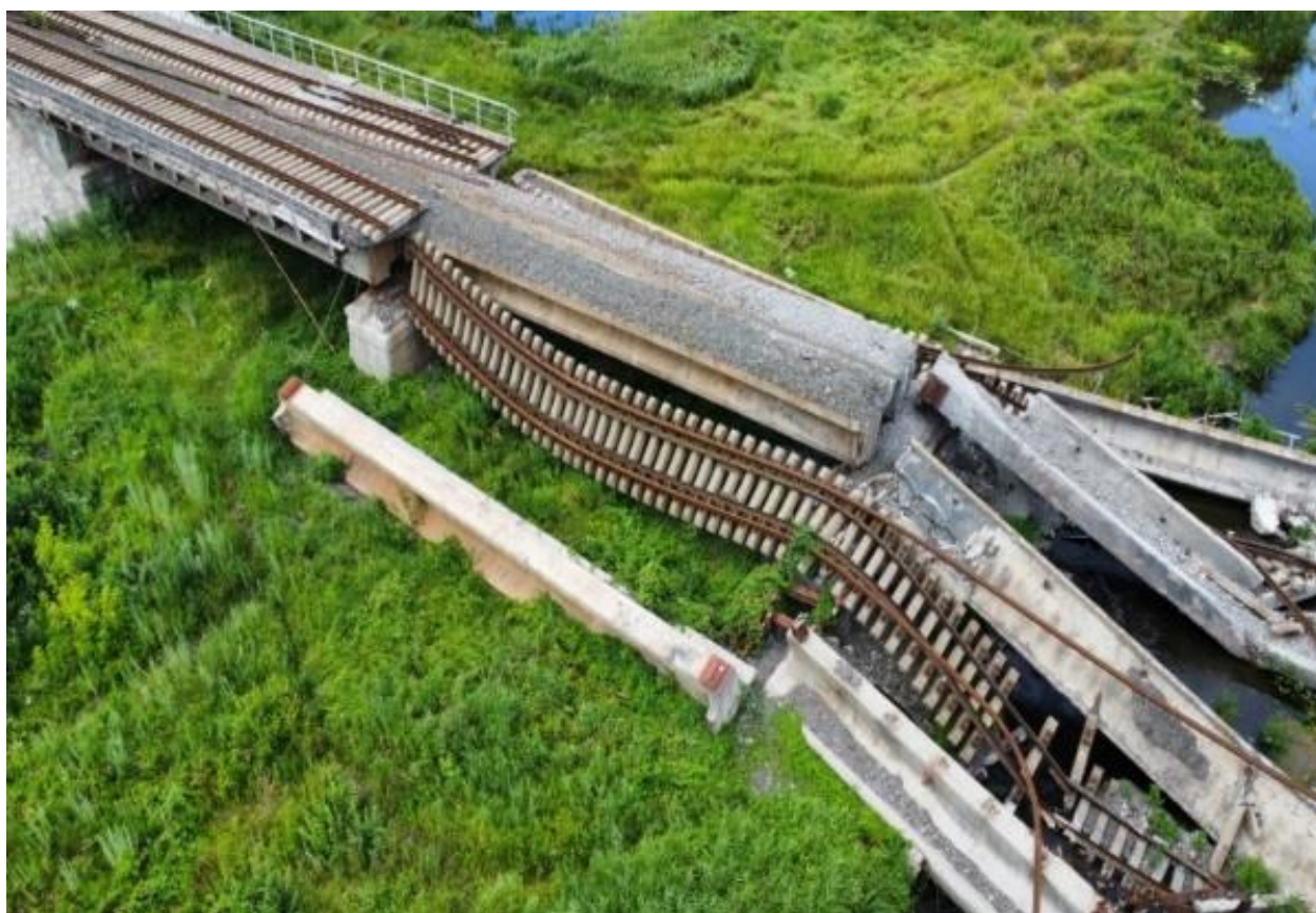
Рисунок 3.2 – Часткове руйнування мосту з руйнуванням прогонових будов
