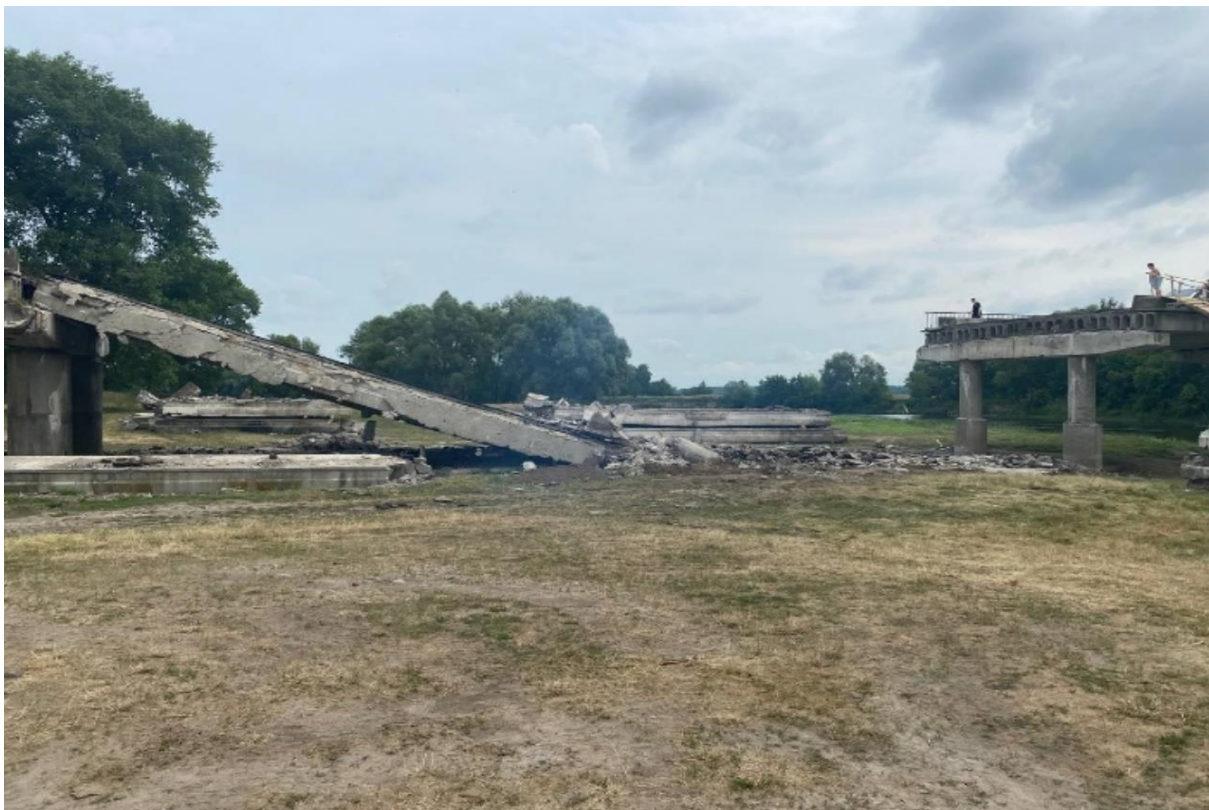
Рисунок 3.8 – Обрушення прогонових споруд мосту через р. Сейм
