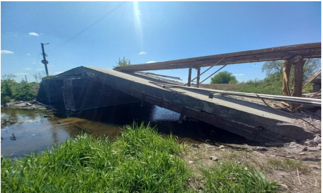
Рисунок 2.1 – Руйнування прогонових споруд та опор внаслідок підриву
