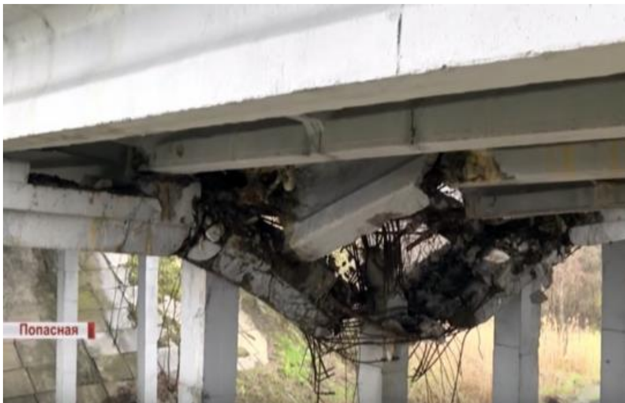
Рисунок 2.2 – Часткове пошкодження прогонових споруд та опор
