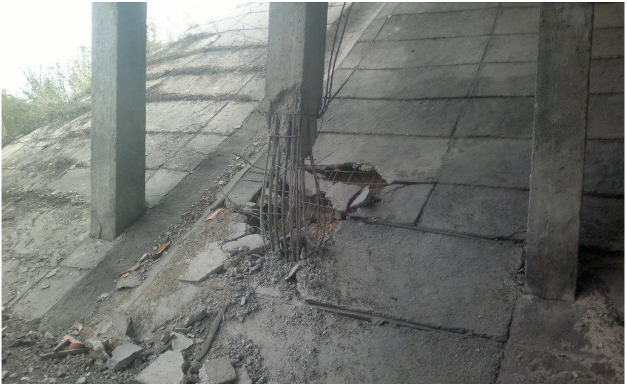
Рисунок 2.4 – Руйнування пального фундаменту опори естакадного типу
