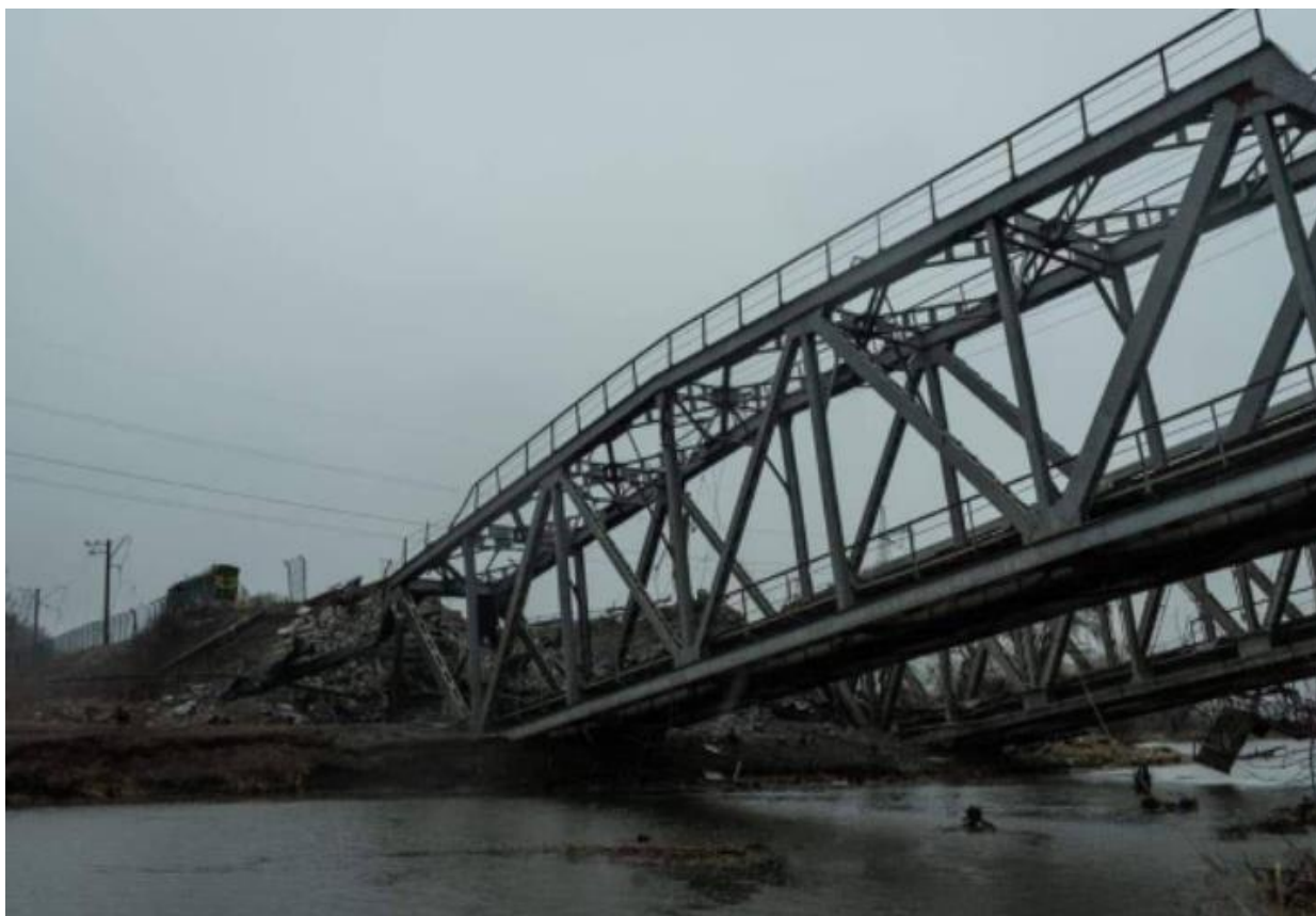
Рисунок 3.1 – Підривання берегових опор. Залізничний міст між Ірпенем та Києвом
