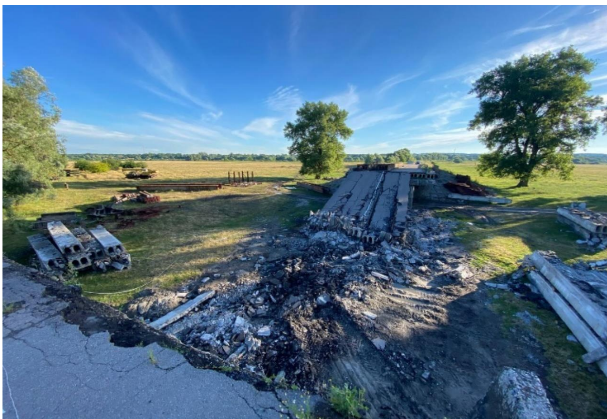
Рисунок 3.9 – Характер руйнування опори мосту через р. Сейм
