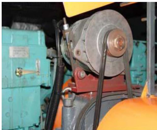
Рисунок 2.26 – Вигляд на вбудований допоміжний генератор (24 В, 120А)
