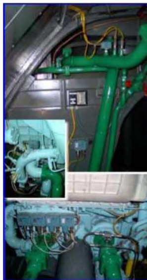
Рисунок 2.9 – Загальний вигляд на вбудовані пристрої автоматичного регулювання температури
