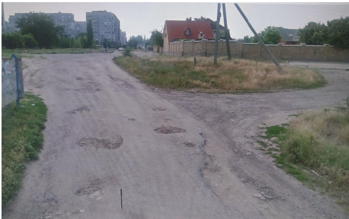
Рисунок 2.23 – Присутня велика кількість вибоїн та зруйнована кромка дорожнього покриття
