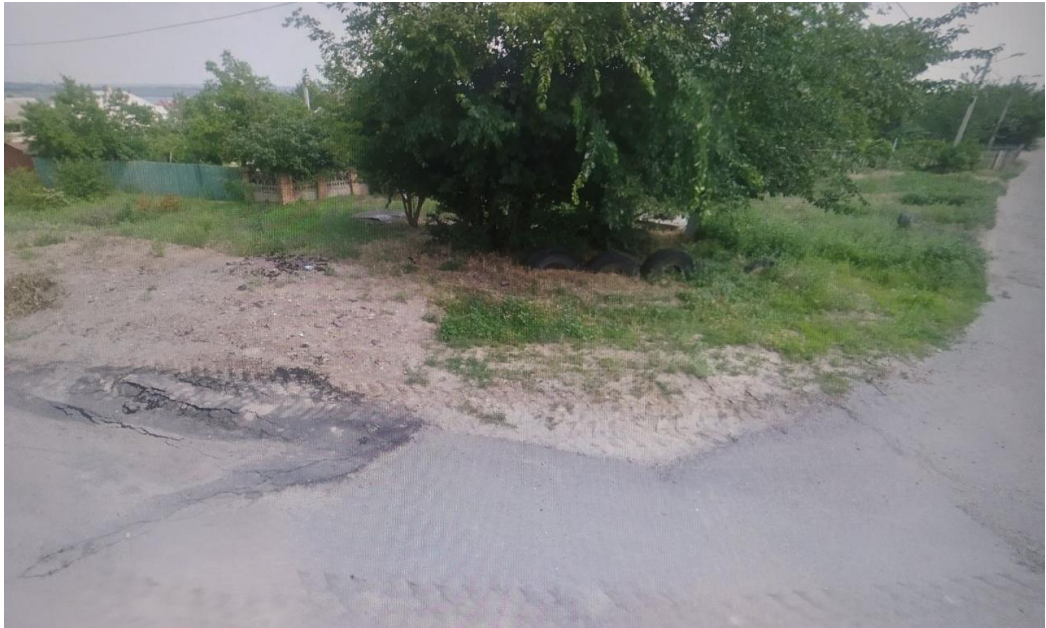
Рисунок 2.20 – Колійність з вибоїнами в асфальтобетонному покритті та несплановані узбіччя
