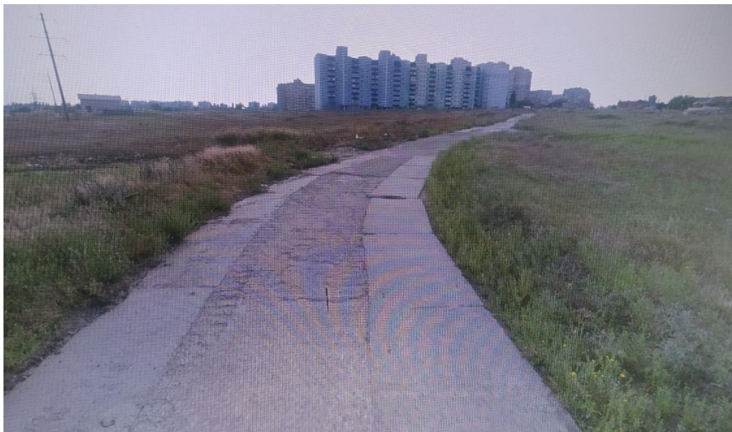
Рисунок 2.21 – Присутні укладені залізобетонні плити вздовж дороги, яка має поперечні тріщини
