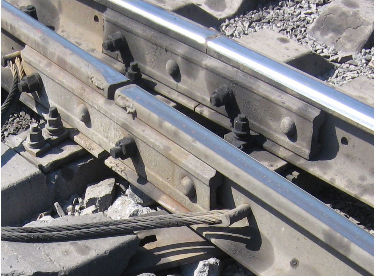
Рис. 2.17 Руйнування залізобетонного бруса у стику.
