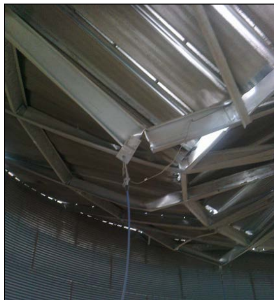
Рис. 9. Руйнування криши силосної споруди внаслідок втомних деформацій
