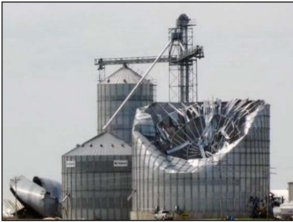
Рис. 17. Руйнування корпусу силосної споруди внаслідок нерівномірного завантаження
