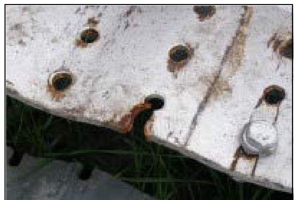
Рис. 12. Розрив обшивки силосної споруди в місці розташування болтових отворів
