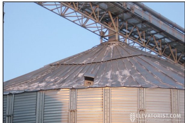
Рис. 6. Деформація криши силосу від снігового навантаження
