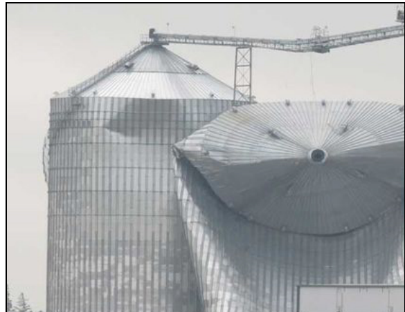
Рис. 19. Руйнування обшивки силосної споруди внаслідок удару агломерату сипучого матеріалу при розвантаженні
