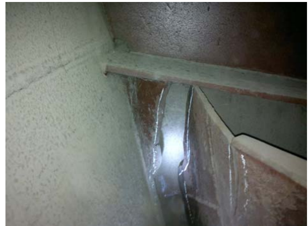
Рис. 5. Обрыв тяги в зоне её примыкания к боковой стенке главной балки со стороны нижнего бьефа
