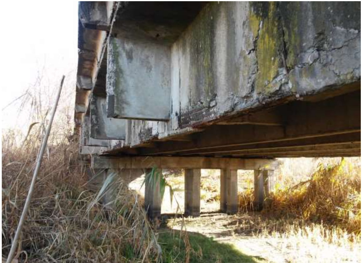
Рисунок 1.7 – Руйнування захисного шару по нижньому поясу балки Б1
