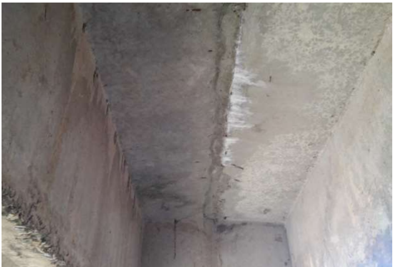
Рисунок 1.9 – Вилуговування бетону плити прогонової будови.
