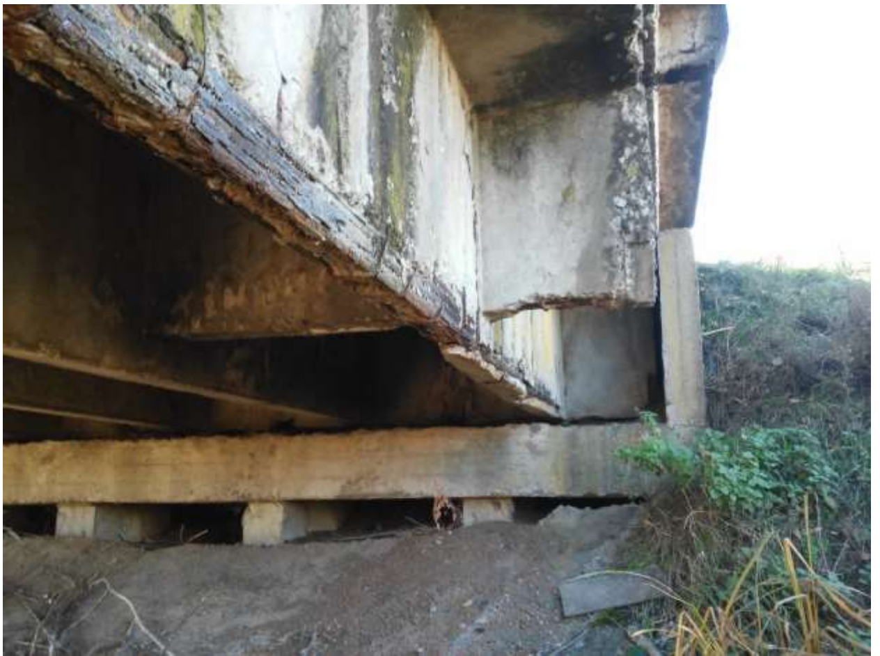
Рисунок 1.8 – Корозії робочої арматури балки Б1 ПБ 1-2
