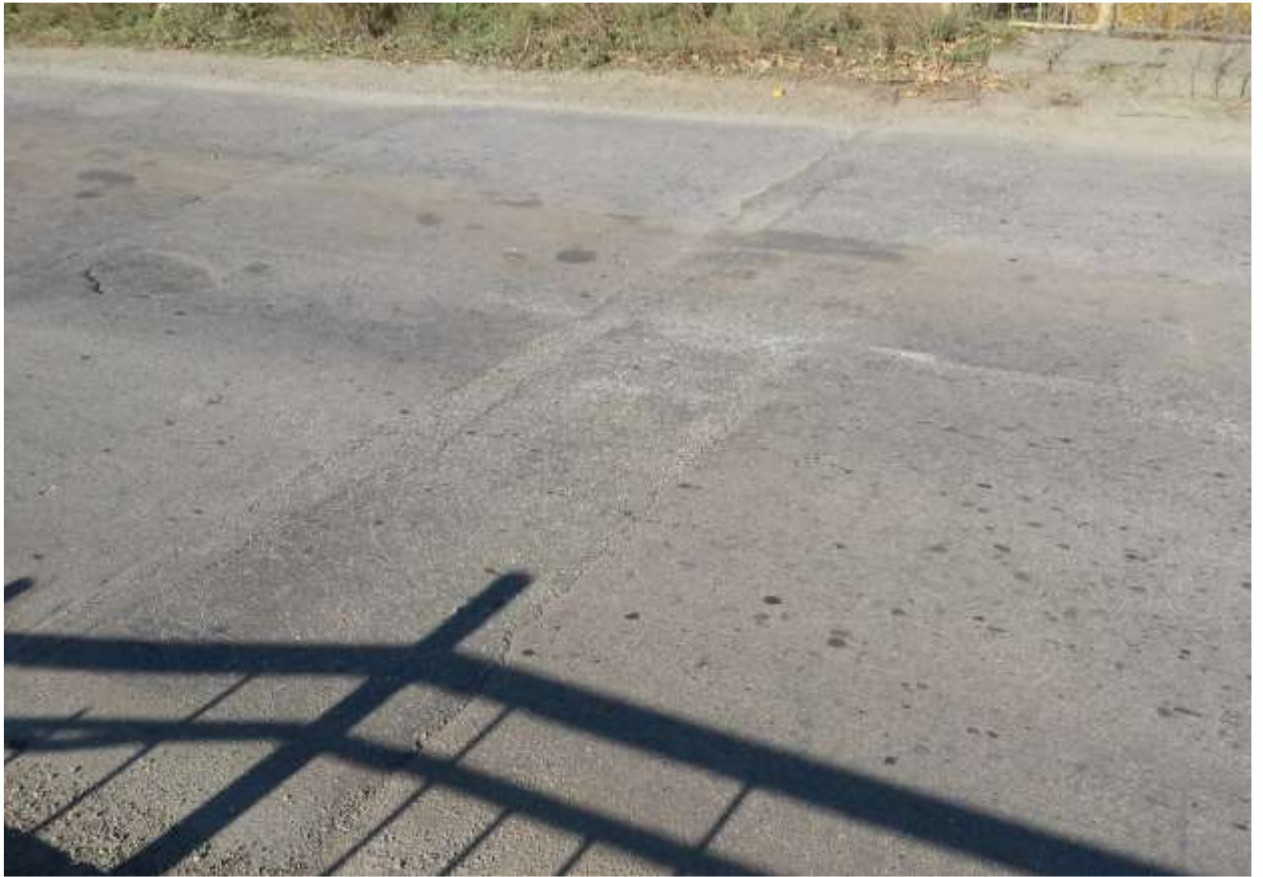
Рисунок 1.10 – Тріщини в покритті збільшення товщини покриття проїзної частини мосту
