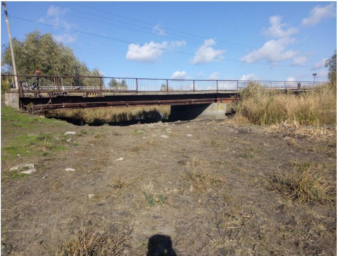
Рисунок 1.1 – Загальний вигляд ділянки мосту з верхової сторони
