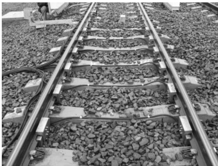
Рисунок 22 – Колійне обладнання комплексу WCM
