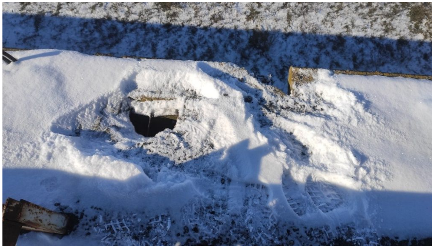
Рисунок 2.14 – Пролом в тротуарних плитах прогонової будови 1-2 праворуч проїзної частини.
