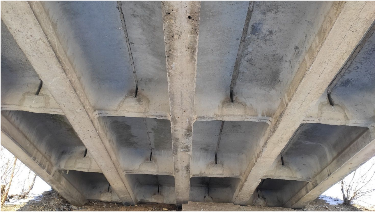
Рисунок 2.1 – Суцільний білий колір бетону з брудними патьоками. Прогонова будова 0-1. Вид на опору № 0
