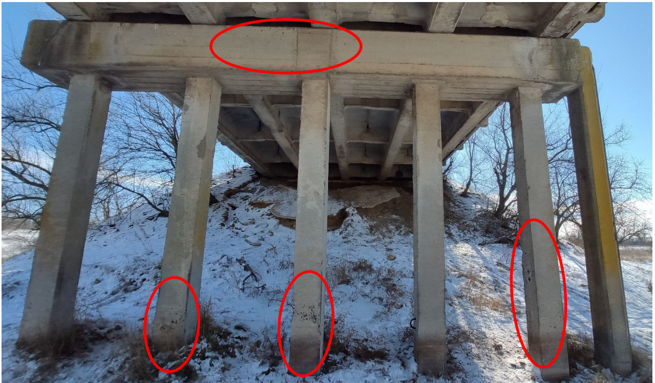
Рисунок 2.8 – Щебенистість і раковини в бетоні. Опора №4.
