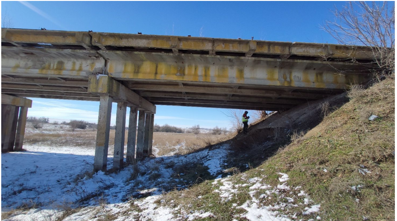
Рисунок 2.3 – Фізична і біологічна корозія бетону на боковій поверхні балки Б1 прогонової будови 0-1.
