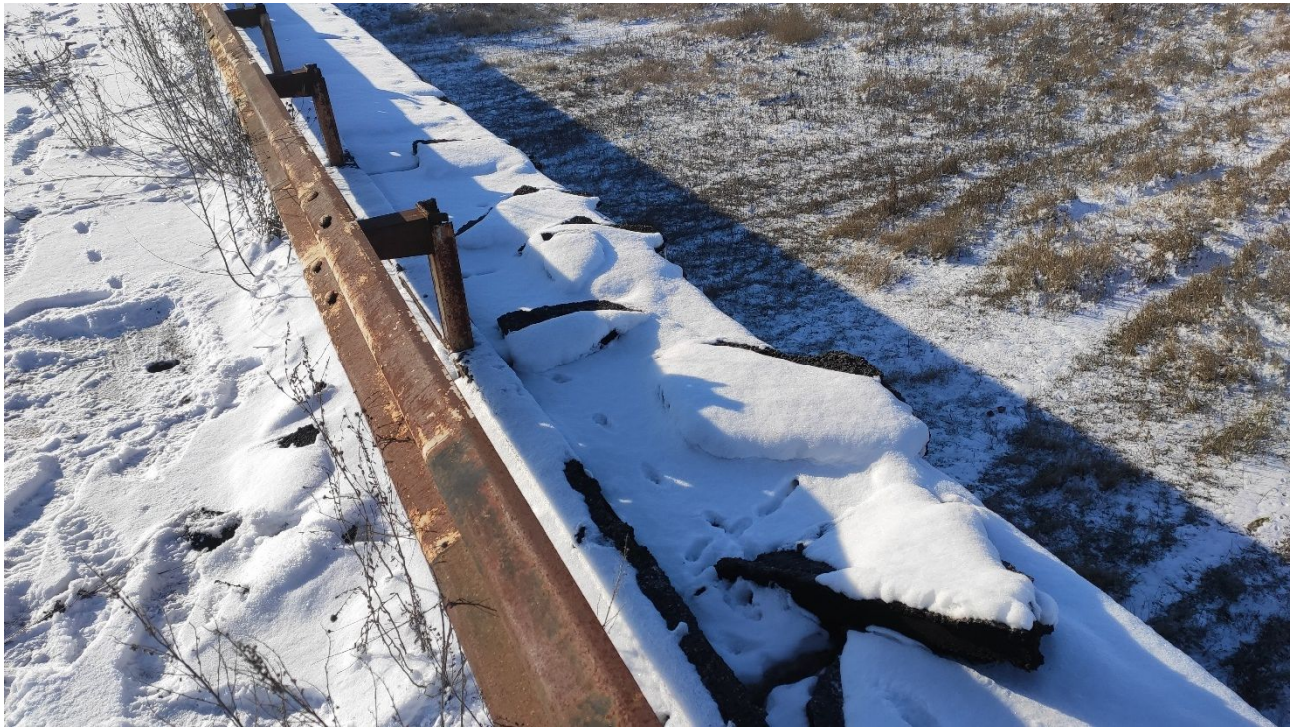
Рисунок 2.15 – Руйнування асфальтобетонного покриття тротуару прогонової будови 0-1 праворуч проїзної частини.
