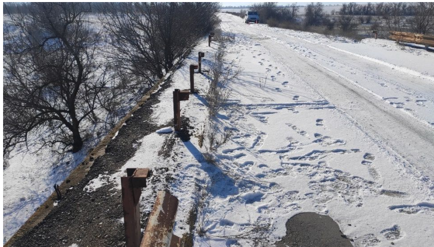
Рисунок 2.12 – Наноси землі, сміття і поросль бур'яну біля бордюрного каменя з обох сторін проїзної частини. Відсутня поручнева огорожа. Відсутнє бар'єрне огороження.
