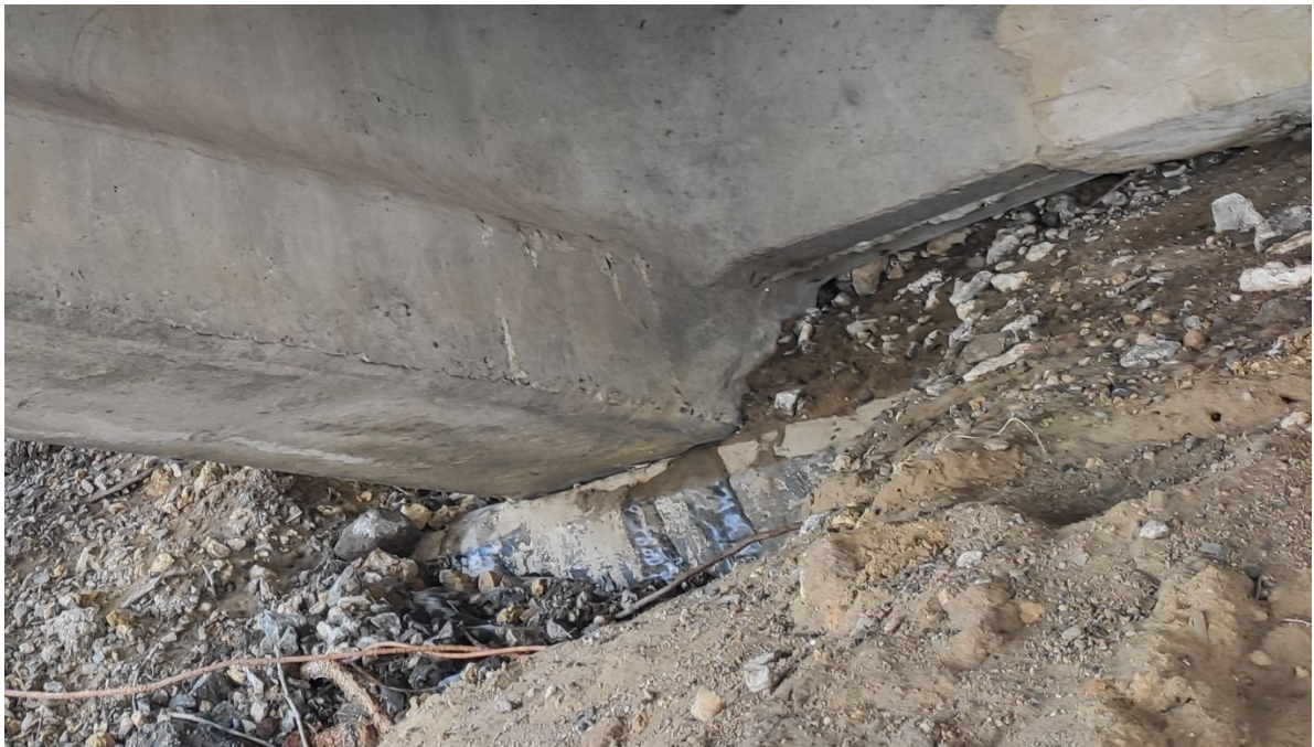
Рисунок 2.9 – Суцільне замокання поверхні ригеля.
