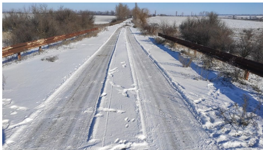
Рисунок 2.17 – Лущення фарби, відсутні болти в з'єднаннях секцій, корозія усіх елементів бар'єрної огорожі на підході з боку м. Казанка.
