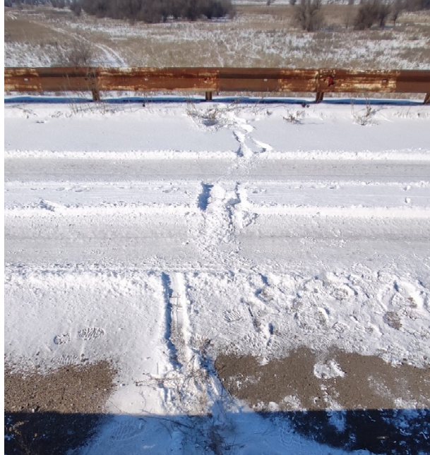
Рисунок 2.11 – Поперечні тріщини у асфальтобетонному покритті проїзної частини у місці встановлення деформаційного шва між прогоновими будовами 2-3 і 3-4.
