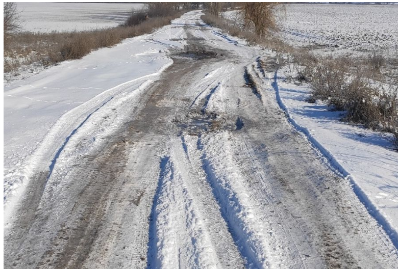
Рисунок 2.16 – Сітка хаотичних тріщин, вибоїни, ями та напливи у асфальтобетонному покритті на підходах до мосту з боку м. Казанка.
