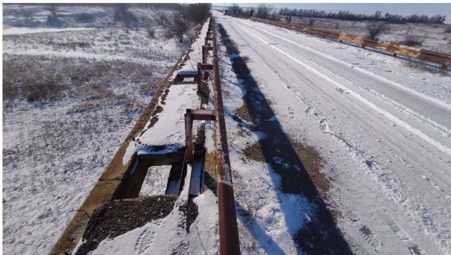
Рисунок 2.13 – Відсутність 2-ох тротуарних плит на прогоновій будові 1-2 ліворуч проїзної частини.
