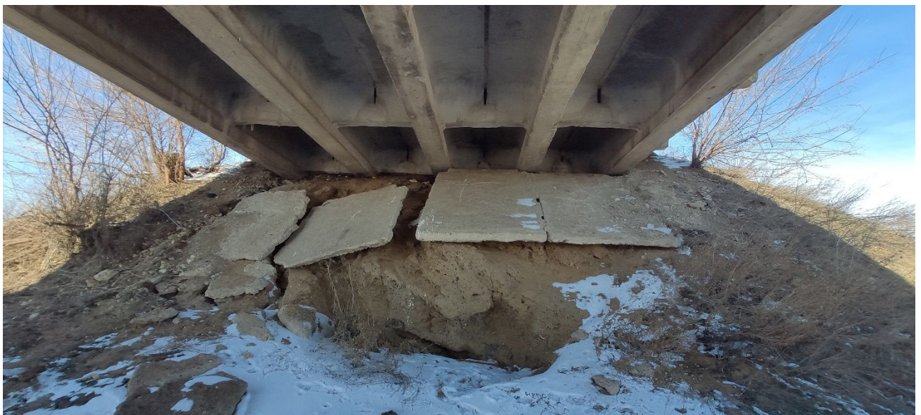
Рисунок 2.10 – Укріплення конусу насипу зруйноване
