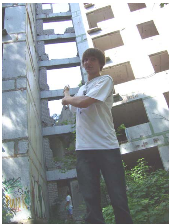
Рис. 4. Обрушение межблочных переходов аварийного дома № 9 (июнь 2012): а) – между 1и 2 подъездами обрушились все конструкции до 2-го этажа; б) – между 3и 4 подъездами еще висят панели бокового ограждения
