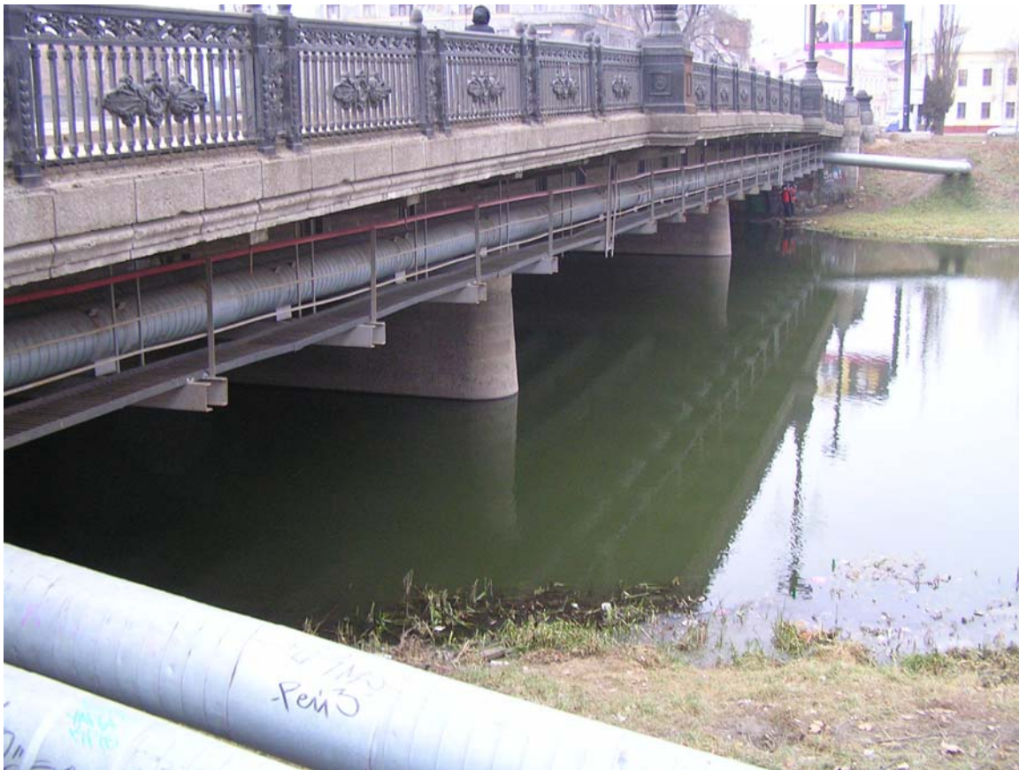
Рис. 1. Размещение труб теплотрассы под тротуаром
