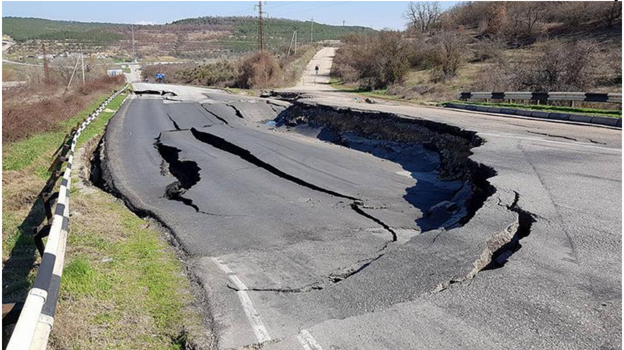
Рисунок 4.7 – Приклад обвалу ґрунту на автомобільній дорозі.
